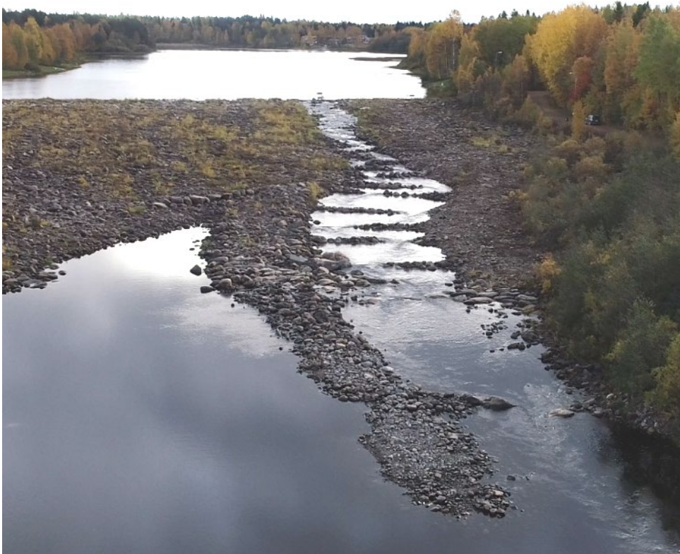
Kuva 2. Uiskarinkosken kalatie kunnostuksen jälkeen kahden kuution vesityksellä syksyllä 2018. Kalatien alaosassa näkyy selkeä houkutusvirtaus kalatiehen (kuva: Seppo Paakkola, Pohjatutkimus ja Mittauspalvelu Oy).
